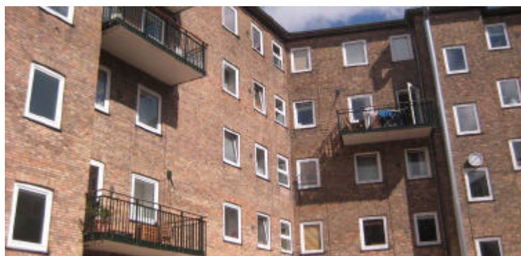
Fugtskadede mursten over sokkelpuds mod Korsikavej.
