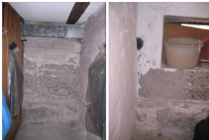
Eksempel på kældervægge med tegn på fugtpres
