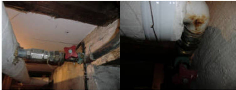
Varmerør i kældre har utidssvarende strengreguleringsventiler
