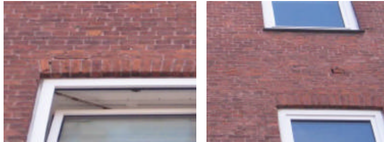
Forskellige skader på murværk
