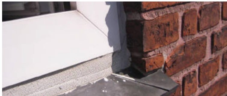
Eksempel på fuger der er blevet ufleksible.
