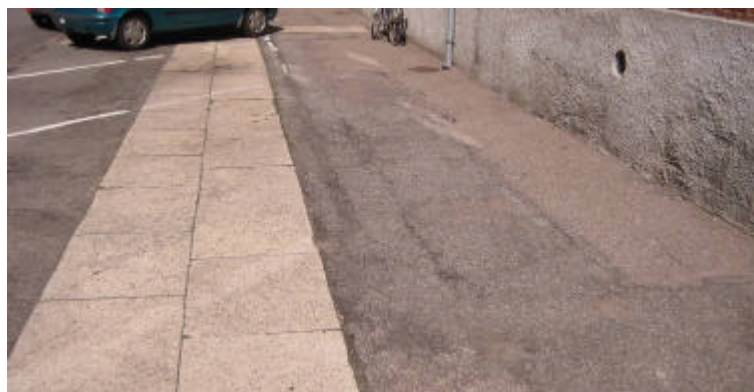
Asfaltbelægninger på Milanovej og Korsikavej er slidte
