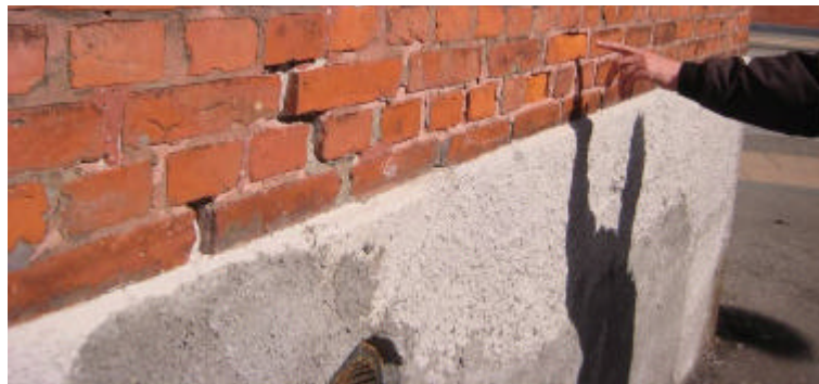
Fugtskadede mursten over sokkelpuds mod Korsikavej.
