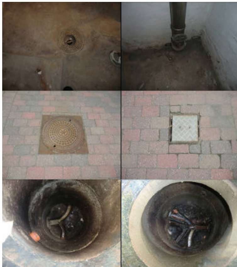
Banketterne i de gamle meterbrønde bør udskiftes
