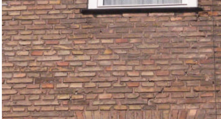
Eksempel på sætningsrevne under vindue .
