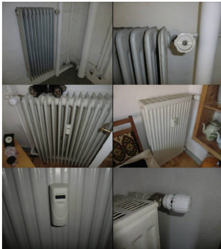
Radiatoranlægget er gammelt men i rimelig god stand
