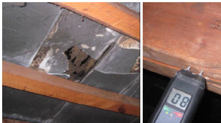
De gamle skifer spær ligger under tagpap.
