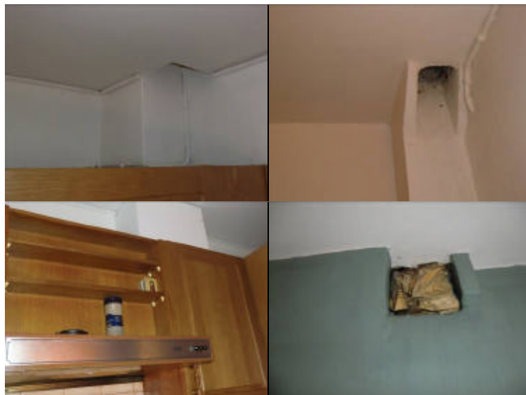
Mekaniske ventilatorer kan give lugtgener hos naboer
